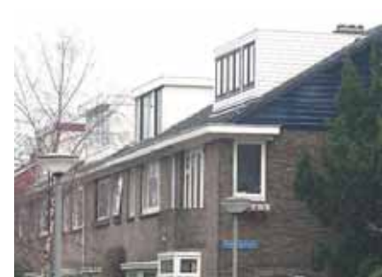
Te grote verschillen op het dak aan de voorzijde
