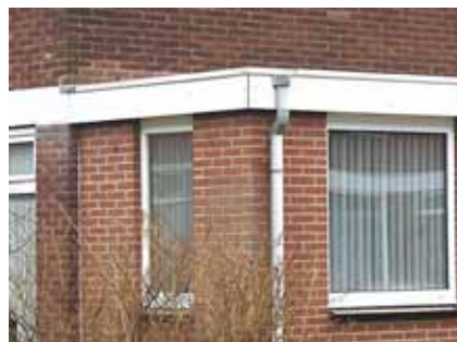
voldoet niet, de detaillering is te grof
