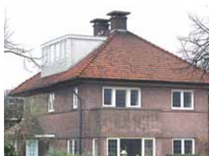
het dichte deel zit niet tussen maar onder de ramen, bovendien is de dakkapel te hoog.
