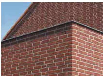
goede detaillering, met een zinken kraalrand in plaats van een boeiboord of dakoverstek, de regenpijp is in de spouwmuur opgenomen.
