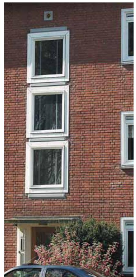
deze kozijnvervanging aan de voorgevel, licht vergunningplichtig, voldoet niet aan redelijke eisen van welstand
