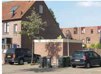
voldoet niet, te gesloten aanbouw
