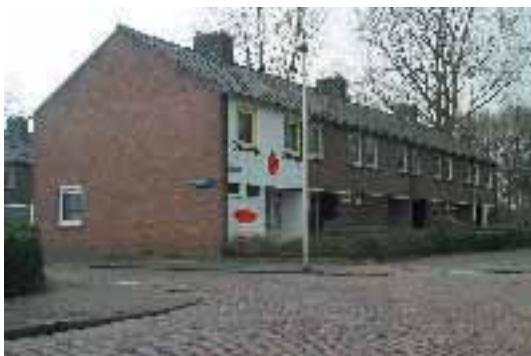
Te individuele manifestatie in een seriematig woningblok. Het geheel schilderen van de gevel verstoort hier het groepsbeeld ernstig. Dit wordt nog versterkt door afwijkend kleurgebruik.
