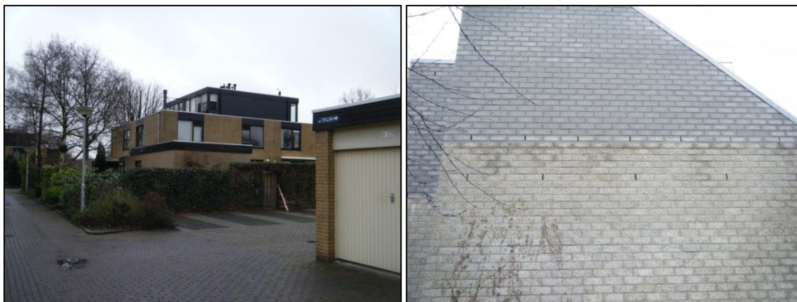
Figuur 2: Linker foto: voor vleermuizen ongeschikte bebouwing in Essesteijn. De dakranden zijn grotendeels afgewerkt met aluminium profielen. De houten delen zitten strak op de muren, spleten zijn afgedicht. Rechter foto: Wel geschikte bebouwing in de wijk Essesteijn met open stootvoegen.
