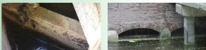
Figuur 22: Overstorten: links als een schuine muur in een rioolput, rechts als muur met opening naar een watergang
