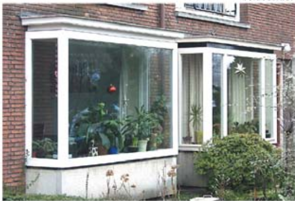
de linker erker mist de indeling en de zwarte rand van het origineel dat nog rechts te zien is, voldoet niet aan redelijke eisen van welstand
