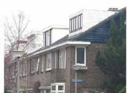
Te grote verschillen op het dak aan de voorzijde
