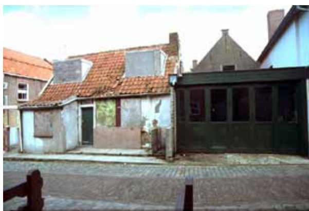
Verkrotting, dichtzetten van gevelopeningen, etc.
