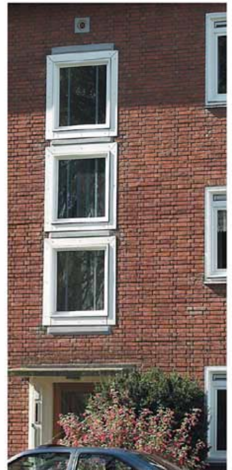
deze kozijnvervanging aan de voorgevel, voldoet niet aan redelijke eisen van welstand
