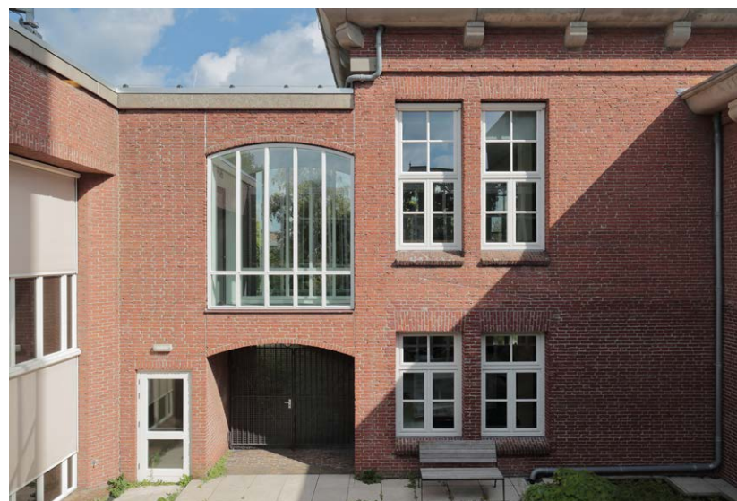
afb. 120: gevel kleine binnenplaats 20123 de laagbouw is afgebroken, de gevels zijn daar op de begane grond opnieuw opgetrokken.
