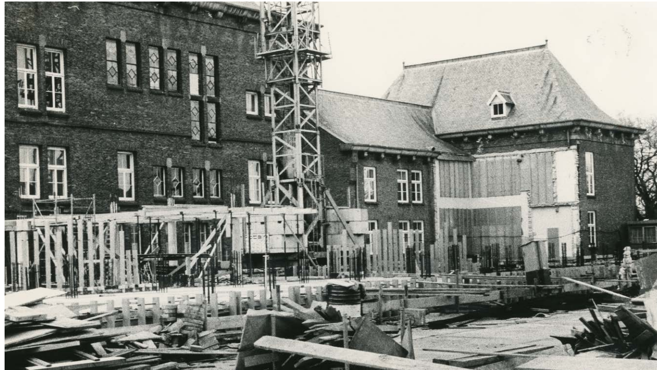
afb. 89: 1980, bouwplaats. [2]. Het trappenhuis tegen de 1961-vleugel is afgebroken (t.p.v. de witte muren). De kozijnen in deze zijvleugel zijn nog rechthoekig; deze zullen gewijzigd worden naar open, getoogde vensters.
